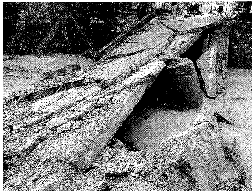
损毁桥梁现场图
