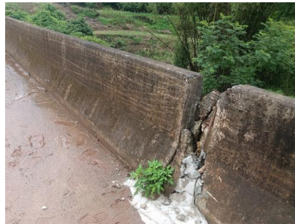
护栏破损、露筋
