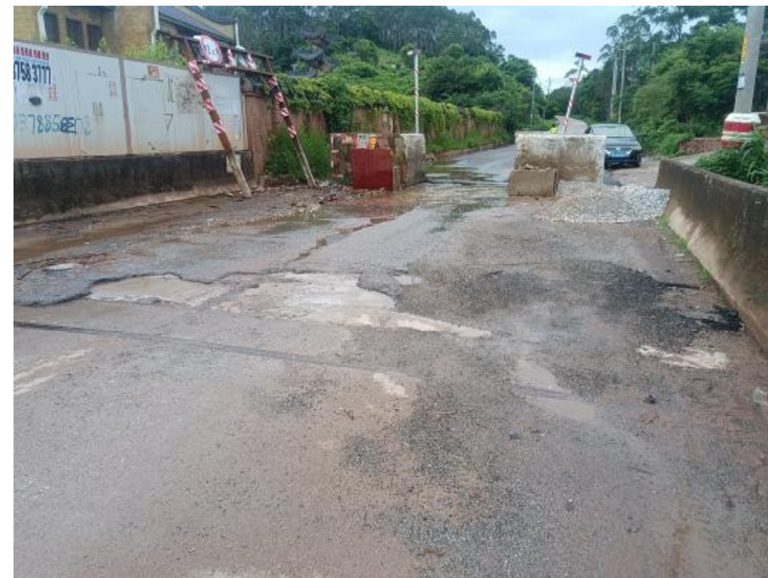
0号桥台台内、台后路面破损、积水
