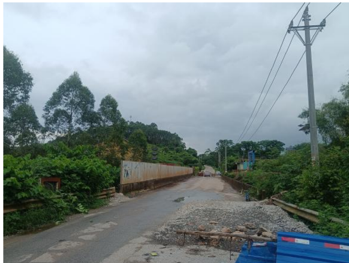
3号桥台台尾道路水毁、下沉
