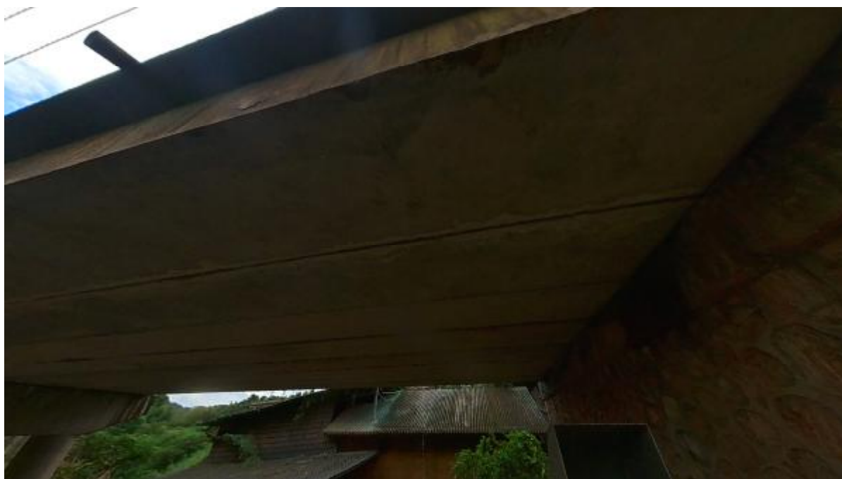
空心板较缝脱落
