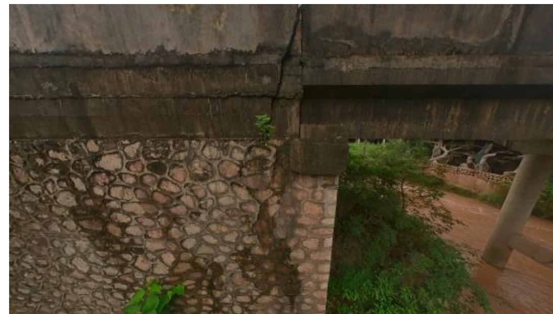
3号桥台侧墙裂缝
