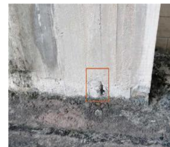
图 2-13 剥落、露筋, 位于 1#横墙
