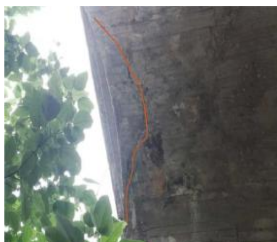
图 2-30 纵向裂缝，位于 6#腹拱圈
