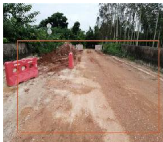
图 2-36 破损，位于 0#台桥面铺装
