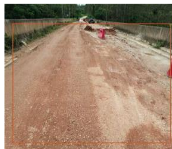
图 2-37 破损，位于 1#跨桥面铺装
