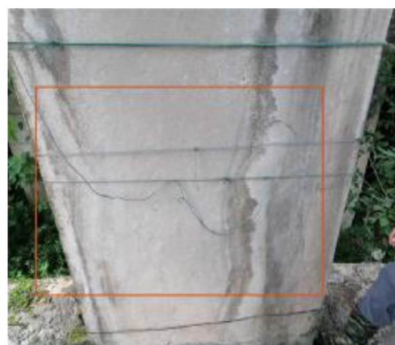
图 2-31 网状裂缝，位于 6#横墙
