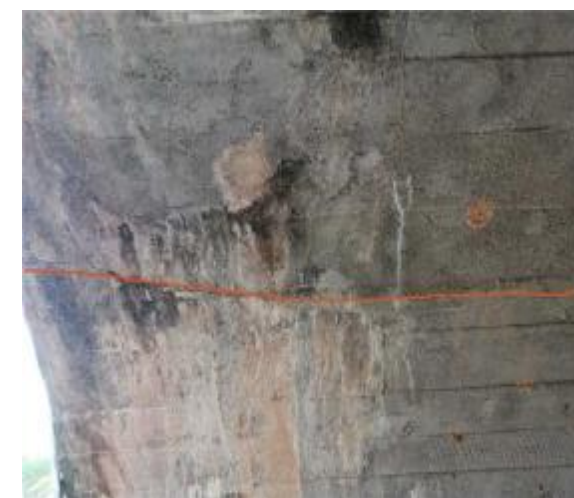
图 2-21 横向裂缝，位于 4#腹拱圈
