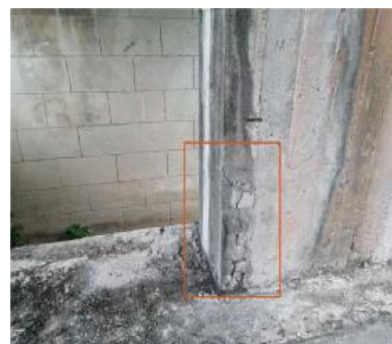
图 2-12 剥落、露筋, 位于 1#横墙
