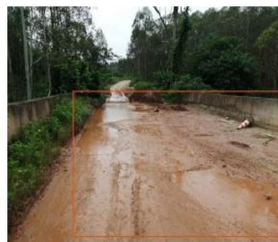
图 2-38 破损，位于 1#台桥面铺装
