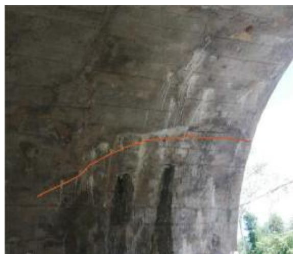
图 2-14 横向裂缝，位于 2#腹拱圈
