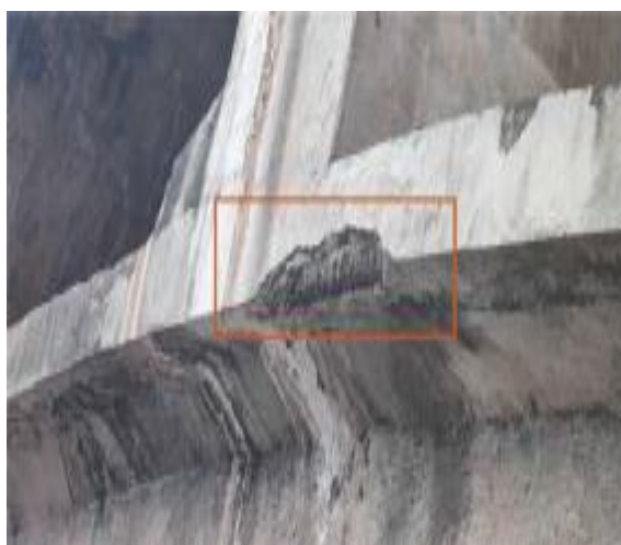
图 2-1 剥落、露筋且锈蚀，位于 1#跨主拱圈
