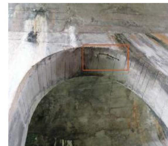
图 2-9 剥落、掉角, 位于 1#横墙
