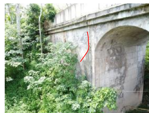
图 2-34 竖向裂缝，位于 R1#翼墙
