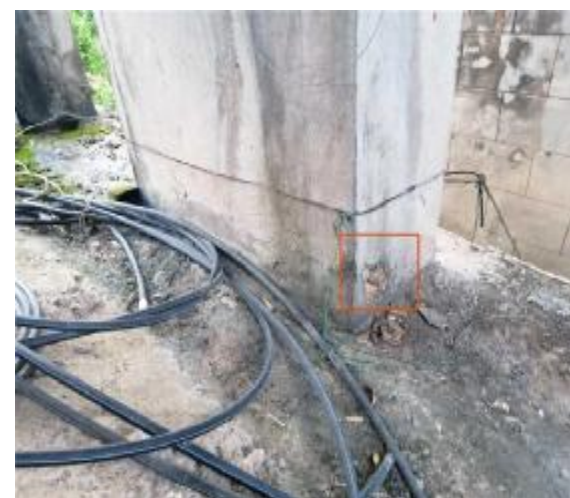
图 2-32 剥落、掉角，位于 6#横墙
