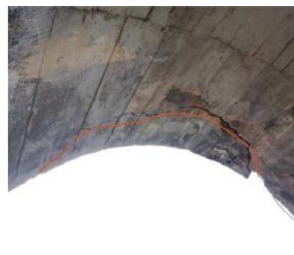
图 2-24 纵向裂缝，位于 4#腹拱圈
