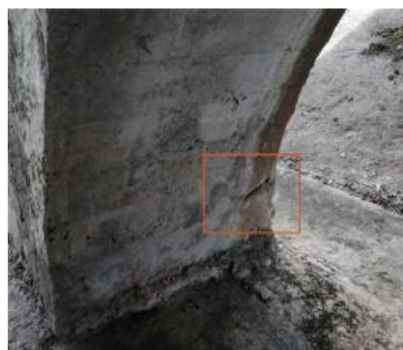
图 2-19 剥落、掉角，位于 2#横墙
