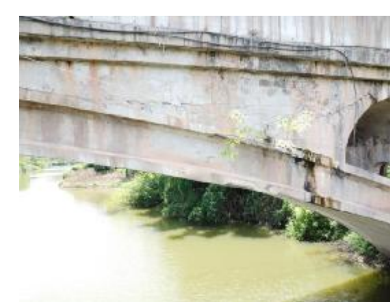
图 2-33 剥落、掉角，位于 R#拱上侧墙
