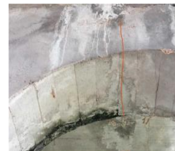
图 2-11 纵向裂缝, [2]位于 1#横墙
