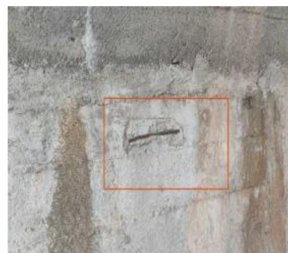
图 2-10 剥落、露筋, 位于 1#横墙
