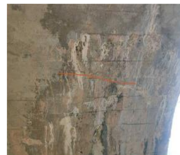
图 2-23 横向裂缝，位于 4#腹拱圈
