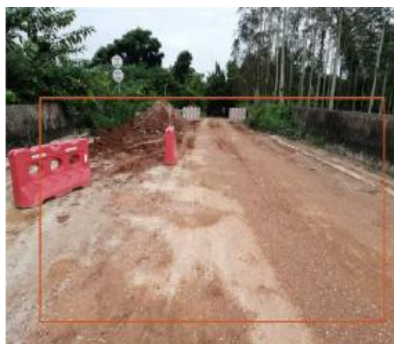
图 2-36 破损, 位于 0#台桥面铺装
