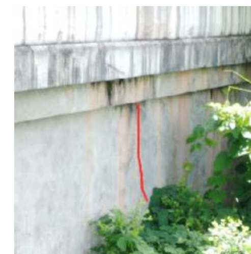
图 2-35 竖向裂缝, 位于 1#台左侧墙
