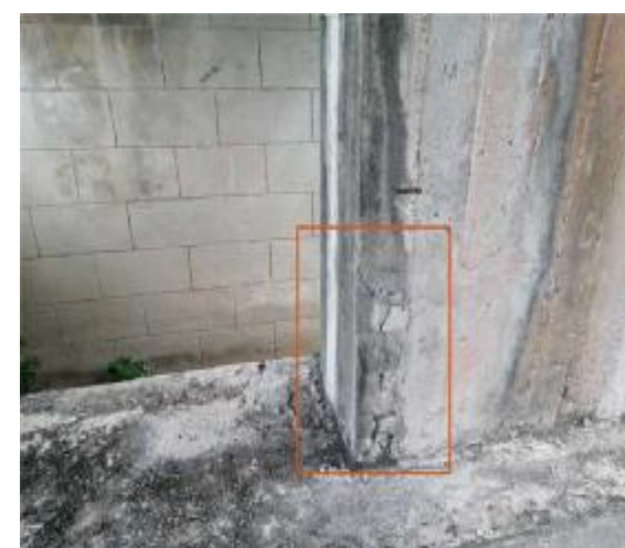
图 2-12 剥落、露筋, 位于 1#横墙
