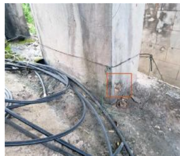
图 2-32 剥落、掉角, 位于 6#横墙
