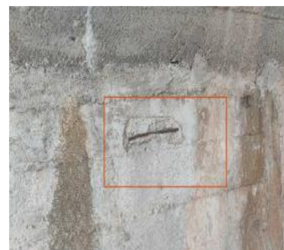
图 2-10 剥落、露筋, 位于 1#横墙
