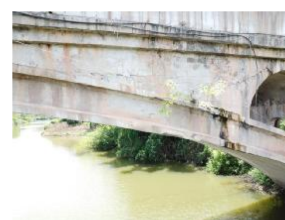
图 2-33 剥落、掉角, 位于 R#拱上侧墙
