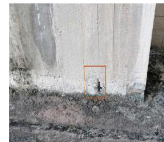
图 2-13 剥落、露筋, 位于 1#横墙
