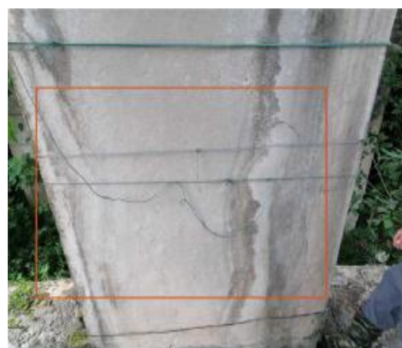
图 2-31 网状裂缝, 位于 6#横墙
