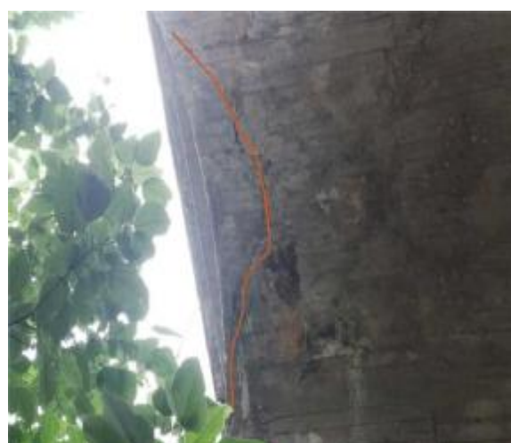
图 2-30 纵向裂缝, 位于 6#腹拱圈
