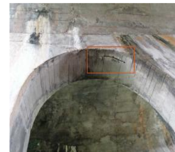
图 2-9 剥落、掉角, 位于 1#横墙
