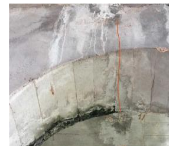
图 2-11 纵向裂缝, [2]位于 1#横墙
