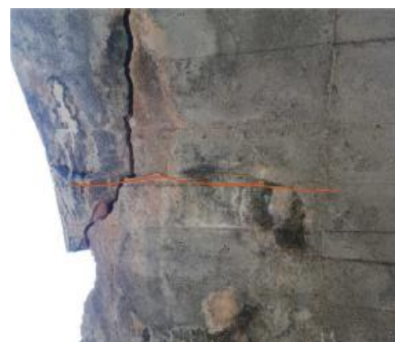
图 2-22 横向裂缝，位于 4#腹拱圈
