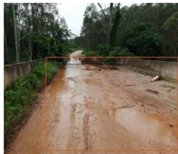
图 2-38 破损, 位于 1#台桥面铺装
