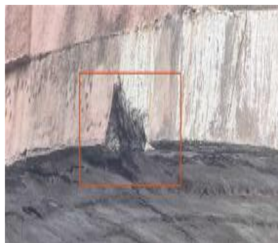
图 2-2 剥落、露筋且锈蚀，位于 1#跨主拱圈
