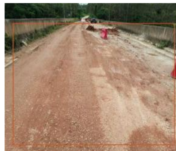
图 2-37 破损, 位于 1#跨桥面铺装
