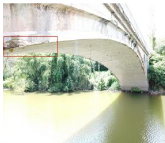
图 2-5 剥落、露筋，位于 1#跨主拱圈
