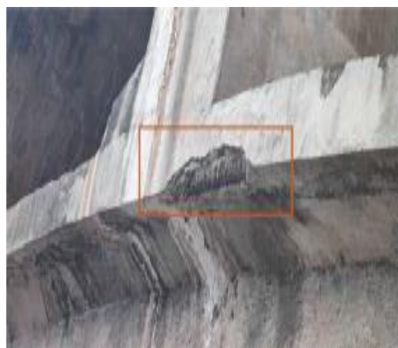
图 2-1 剥落、露筋且锈蚀，位于 1#跨主拱圈
