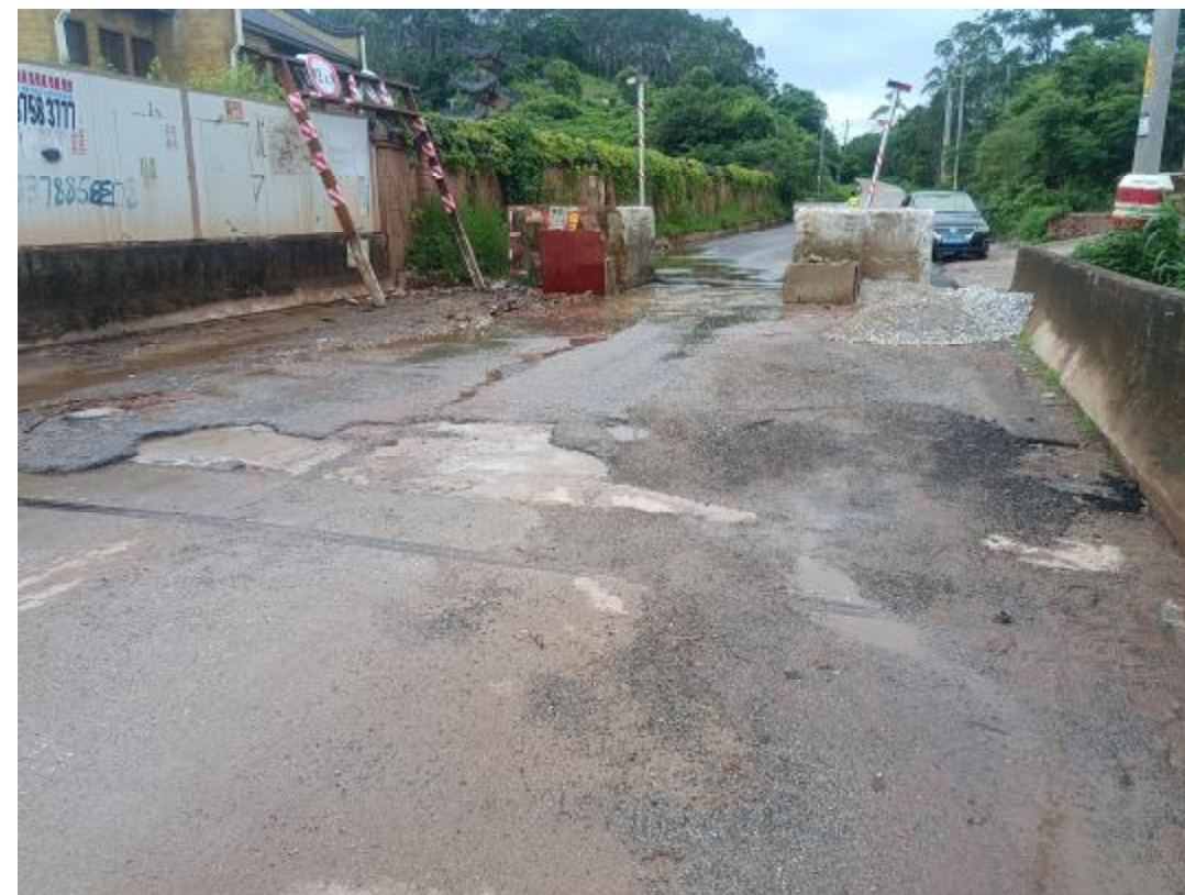
0号桥台台内、台后路面破损、积水
