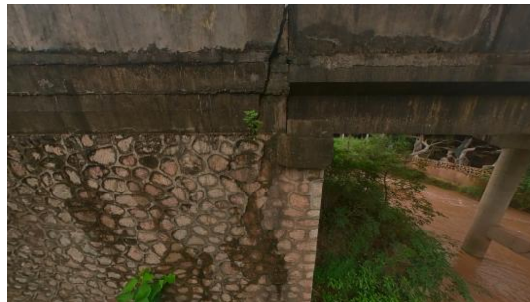
3号桥台侧墙裂缝
