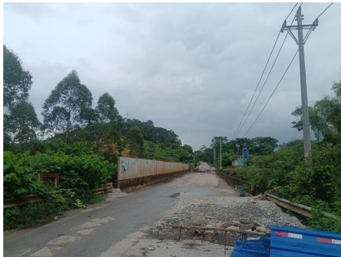
3号桥台台尾道路水毁、下沉
