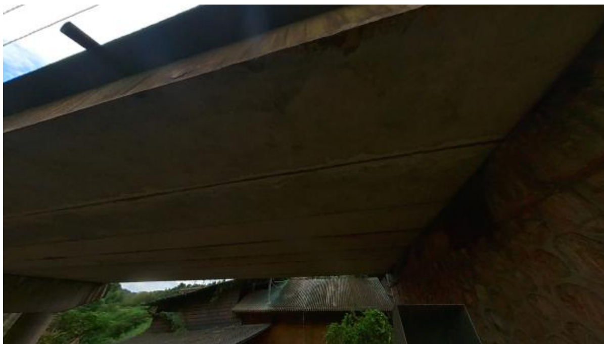
空心板较缝脱落
