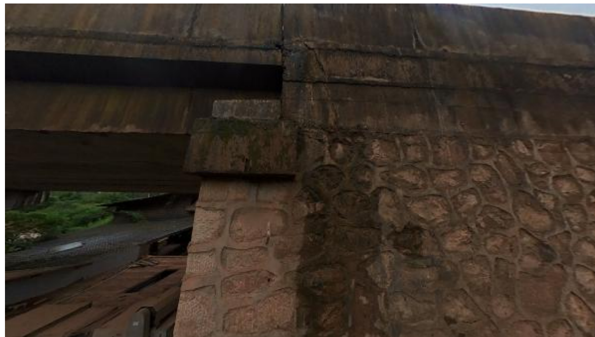
0号桥台侧墙开裂
