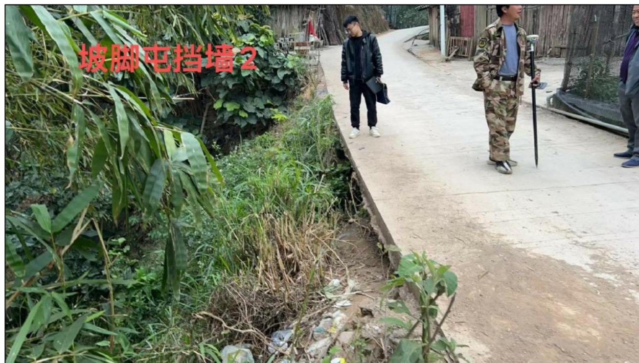
坡脚屯生命防护墙2 现状图
