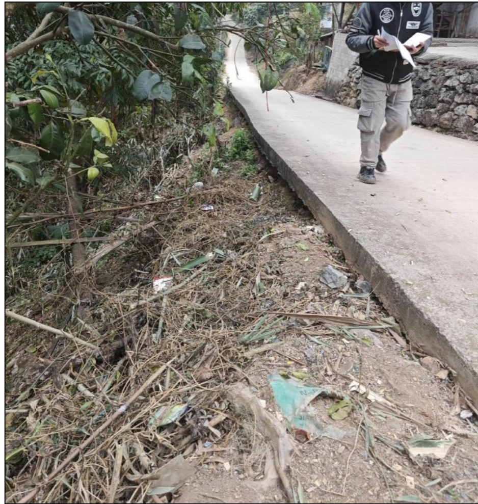
坡脚屯生命防护墙1 现状图
