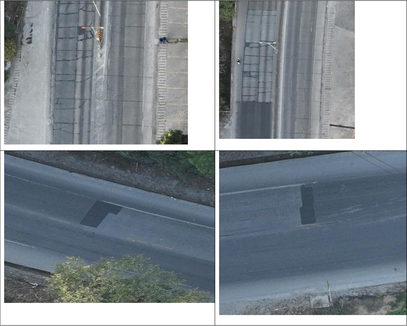
路面现状病害
