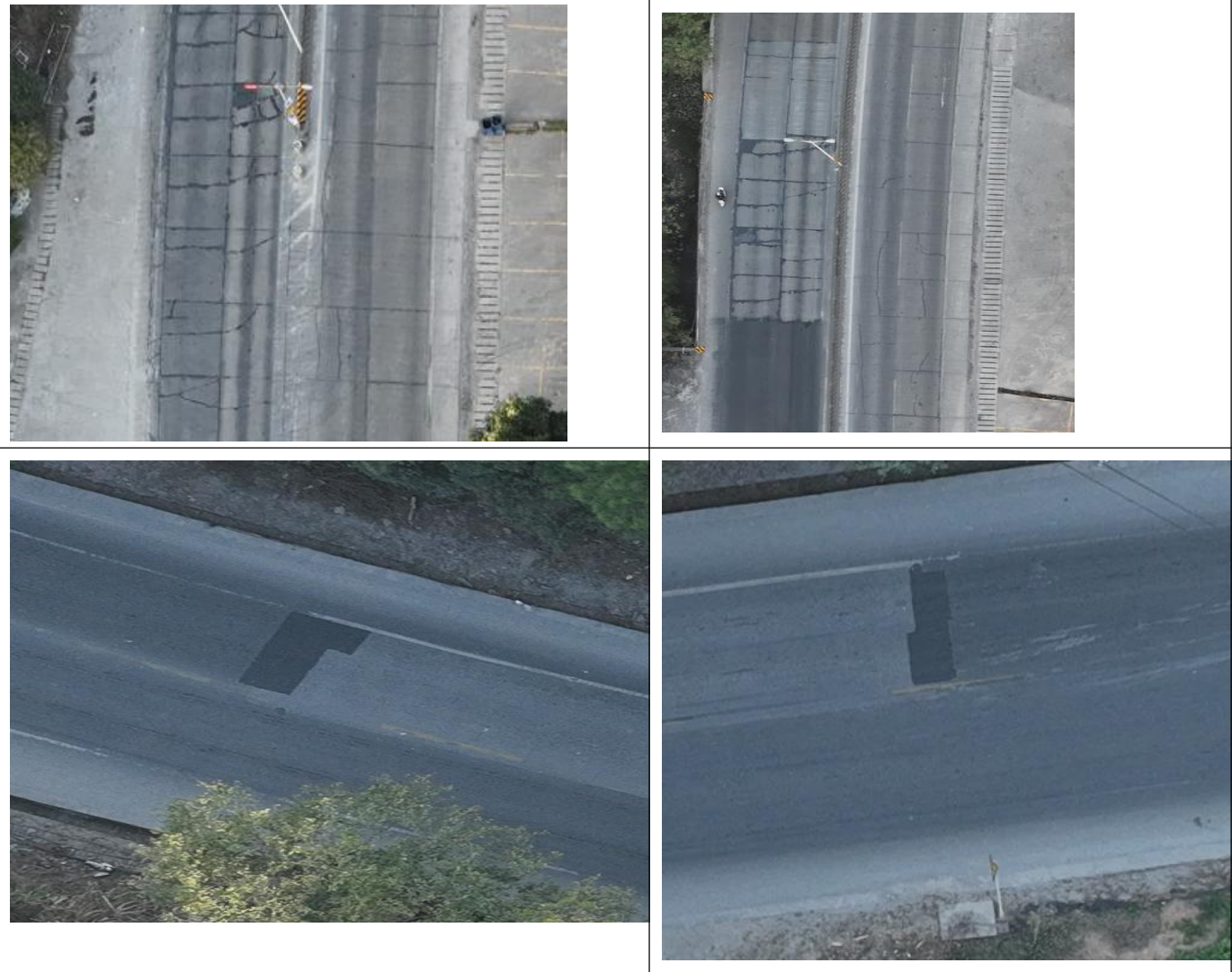
路面现状病害
