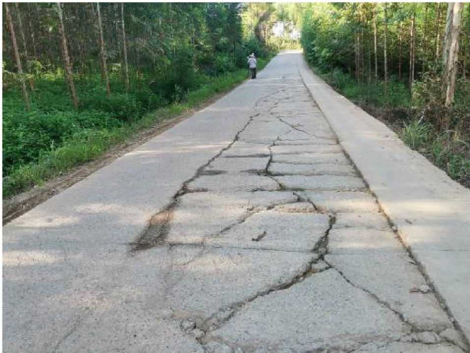
图片3 路面沉降
