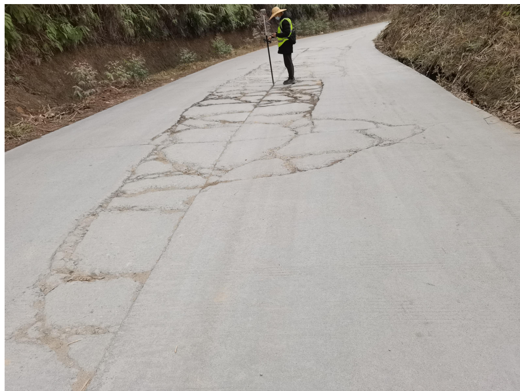
现状附图一：坑块状裂缝
