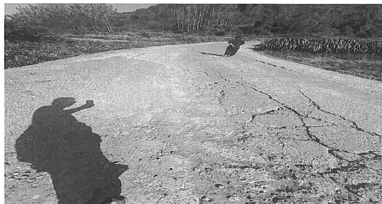
(旧路损毁现场照片)
