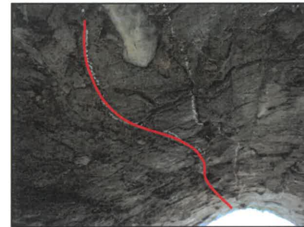
照片 2.1-7 横向裂缝、渗水，位于 2-4#腹拱底面
