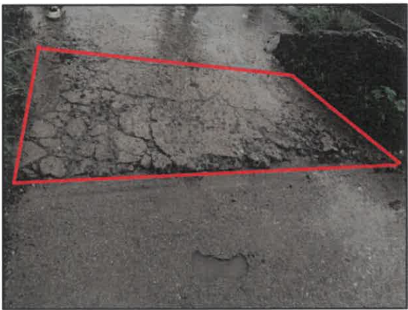
照片 2.1-15 破损，位于 2#台桥面铺装
