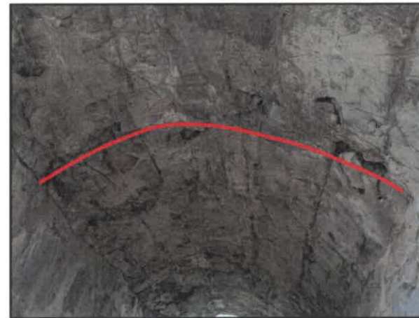
照片 2.1-4 纵向裂缝，位于 1-1#腹拱底面
