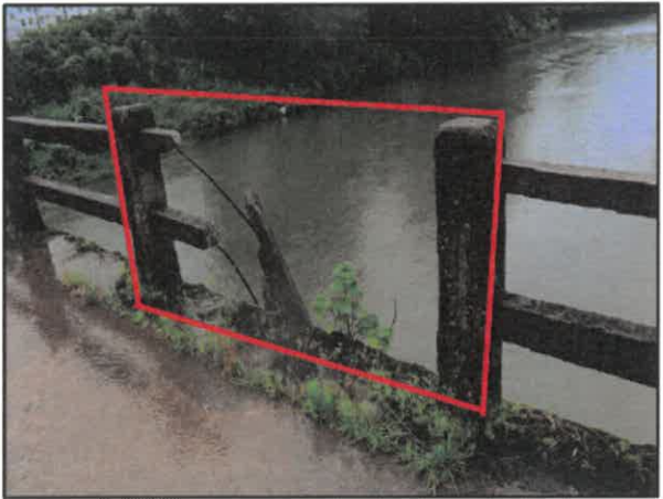
照片 2.1-16 破损，位于左侧护栏 2#跨
