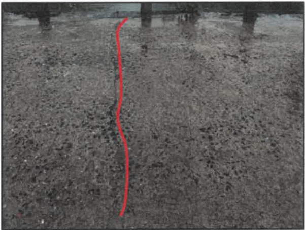
照片 2.1-14 横向裂缝，位于 2#跨桥面铺装
