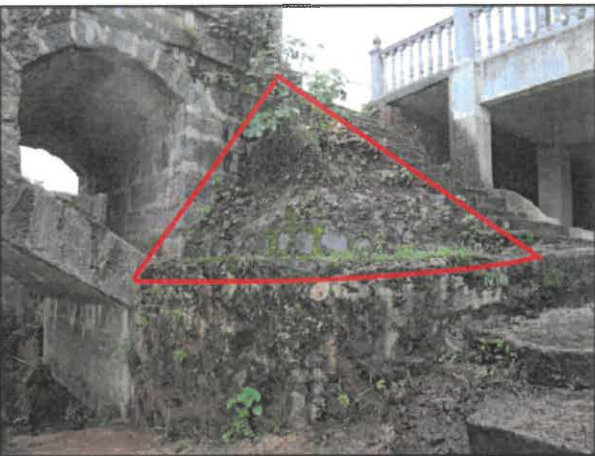
照片 2.1-11 滋生杂草，位于 0#台左侧锥坡
