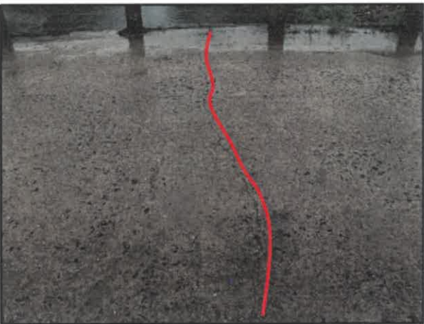
照片 2.1-13 横向裂缝，位于 1#跨桥面铺装
