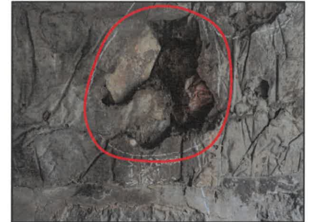
照片 2.1-8 砂浆脱落，位于 1-1#腹拱底面
