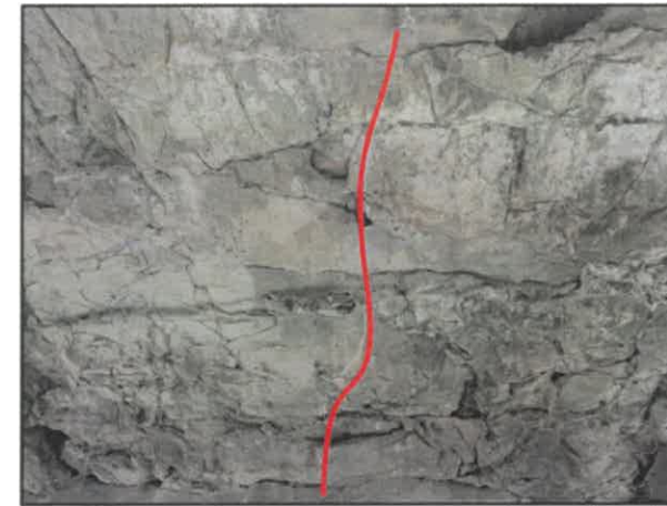
照片 2.1-5 纵向裂缝，位于 1-1#腹拱底面
