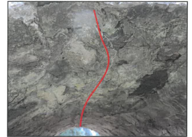
照片 2.1-6 横向裂缝、渗水，位于 1-1#腹拱底面
