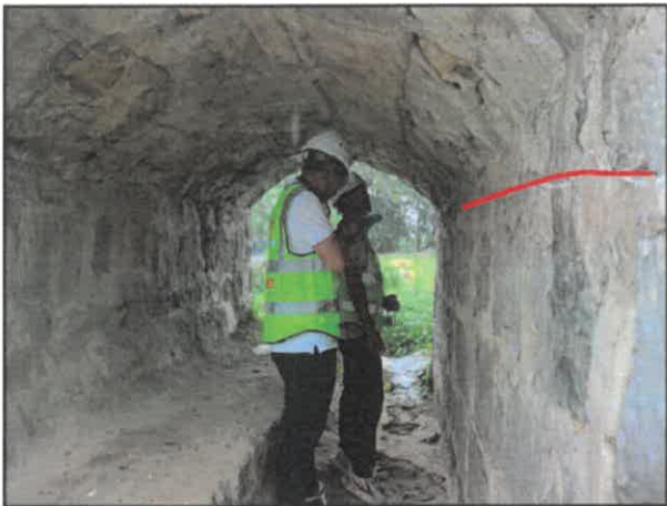
照片 2.1-12 横向裂缝，位于 0#台背墙
