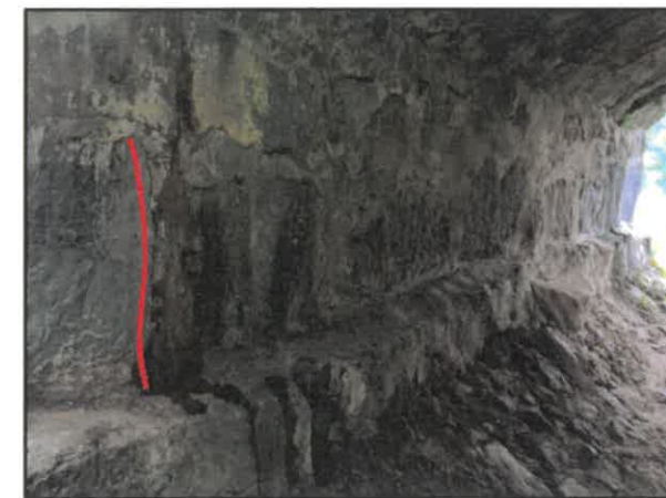
照片 2.1-9 竖向裂缝，位于 2-2#拱上横墙大桩号面
