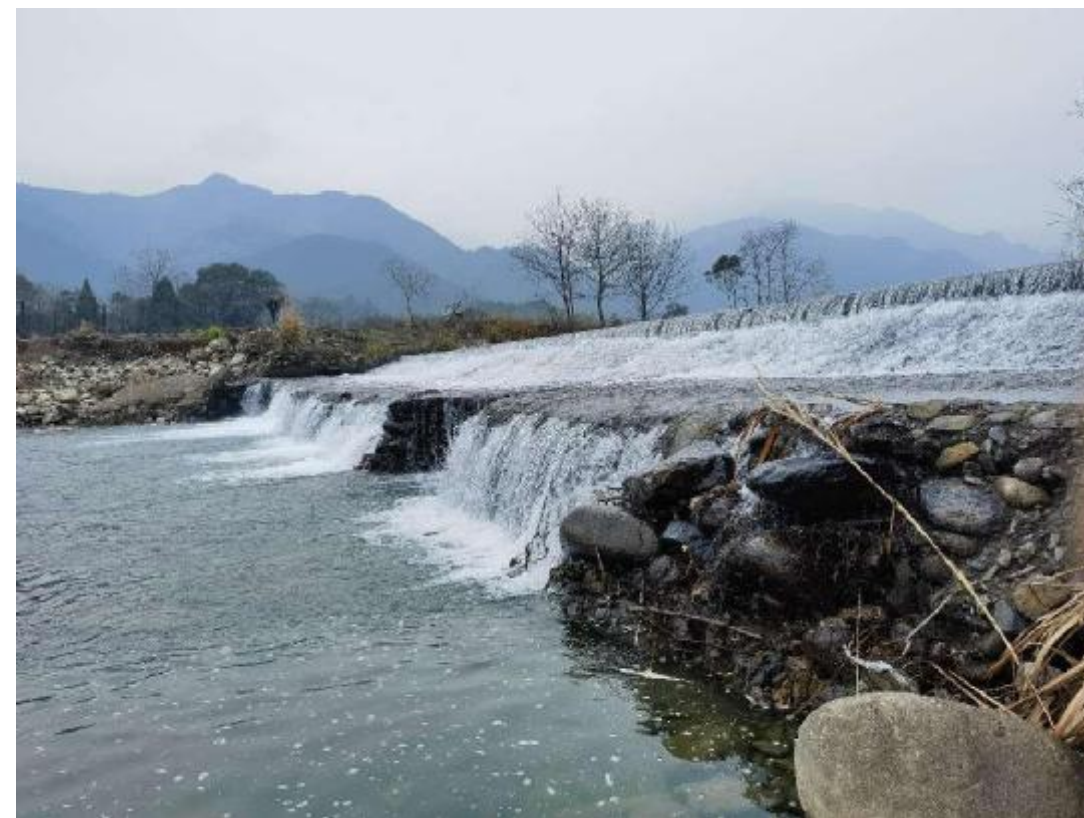
堰坝水毁现状照片
