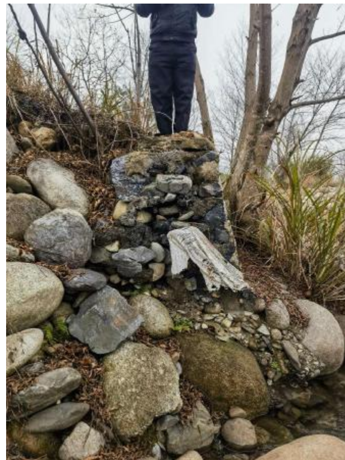
3#防洪堤水毁现状照片
