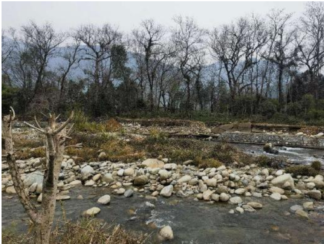
1#防洪堤水毁现状照片
