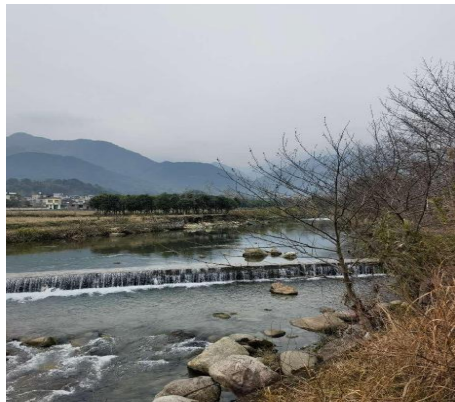
4#防洪堤水毁现状照片
