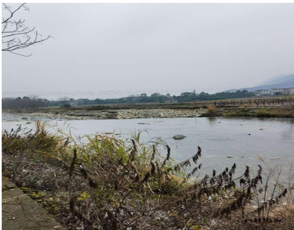
6#防洪堤水毁现状照片
