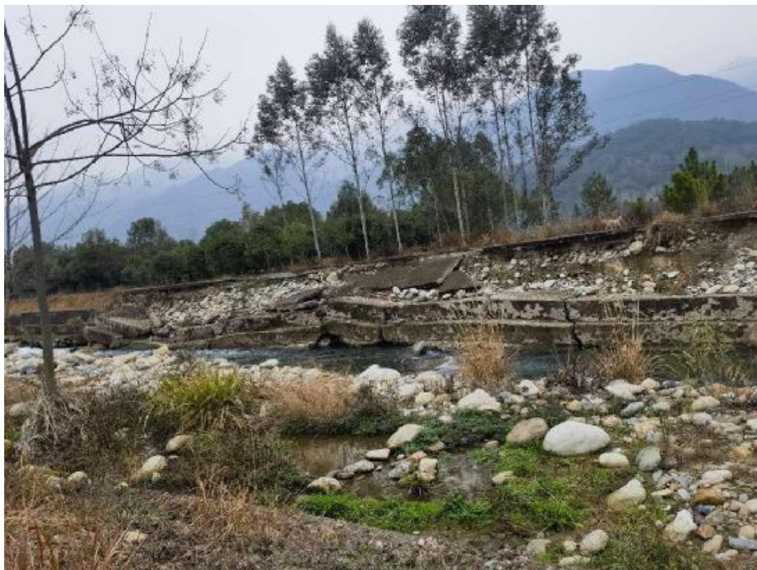
5#防洪堤水毁现状照片
