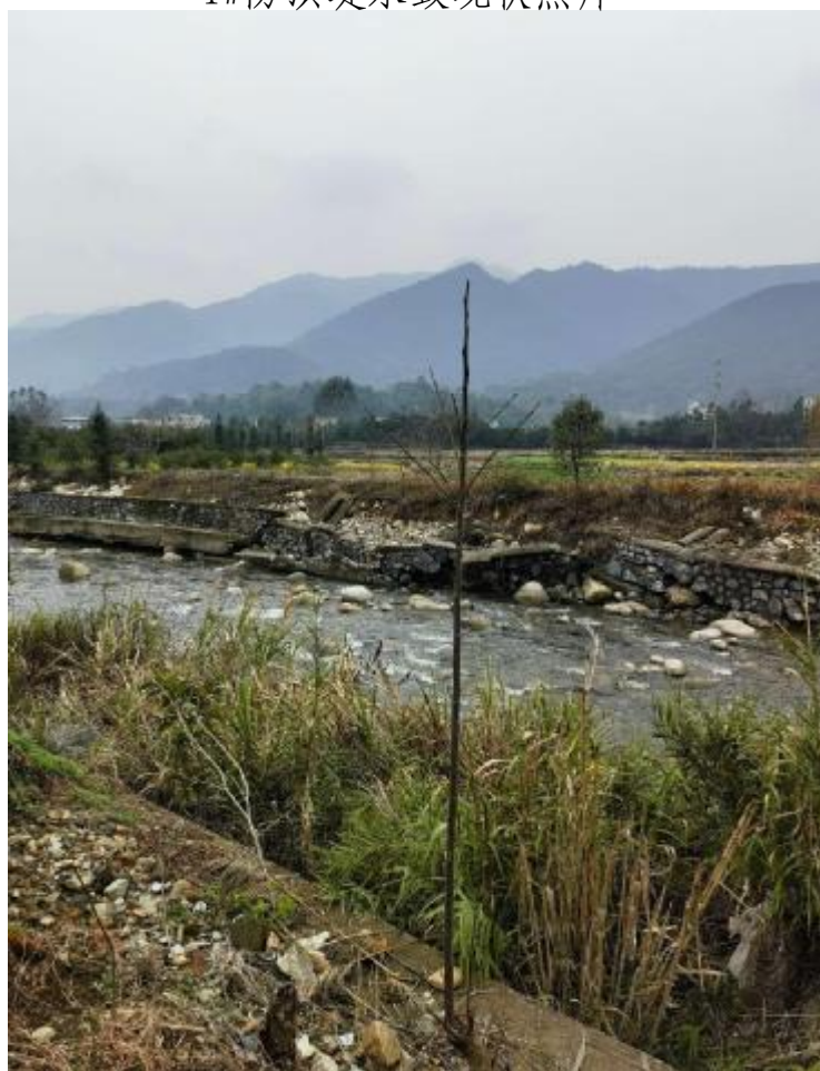
2#防洪堤水毁现状照片
