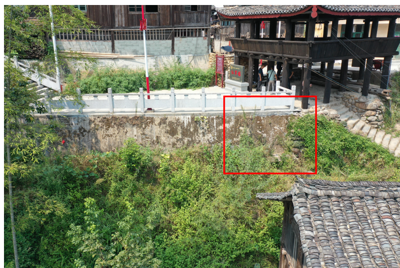
①挡土墙北端紧靠红军楼处开裂
