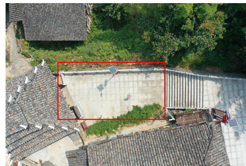
③地面下沉 1-2cm，青石板铺装开裂
