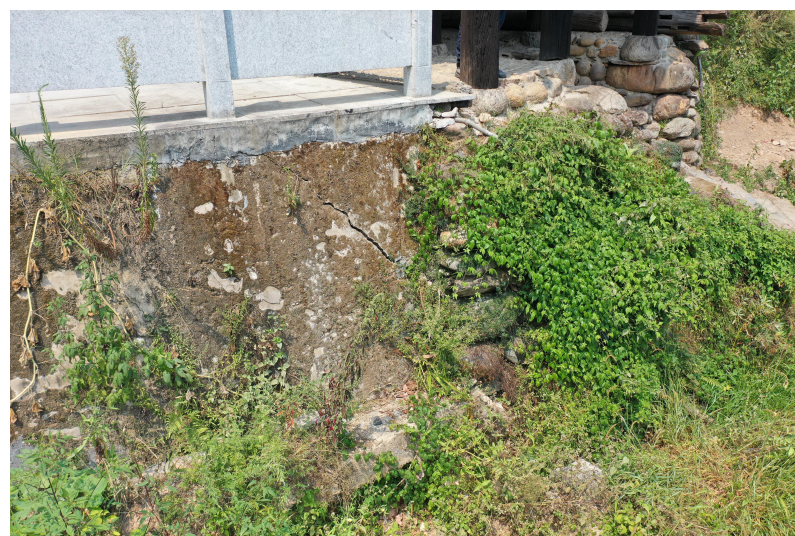
②挡土墙贯通开裂，长 3.12 米，宽 3cm
