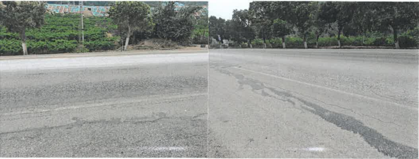
路面现状病害
