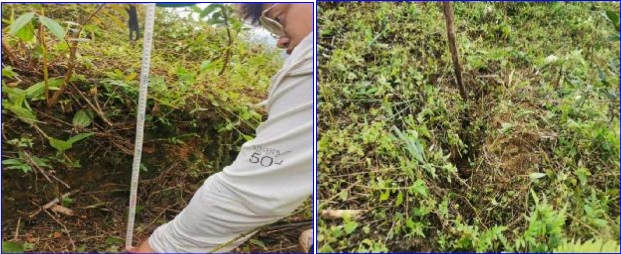
图 1-2 K185+415~K185+520 右侧上边坡塌方现状图
