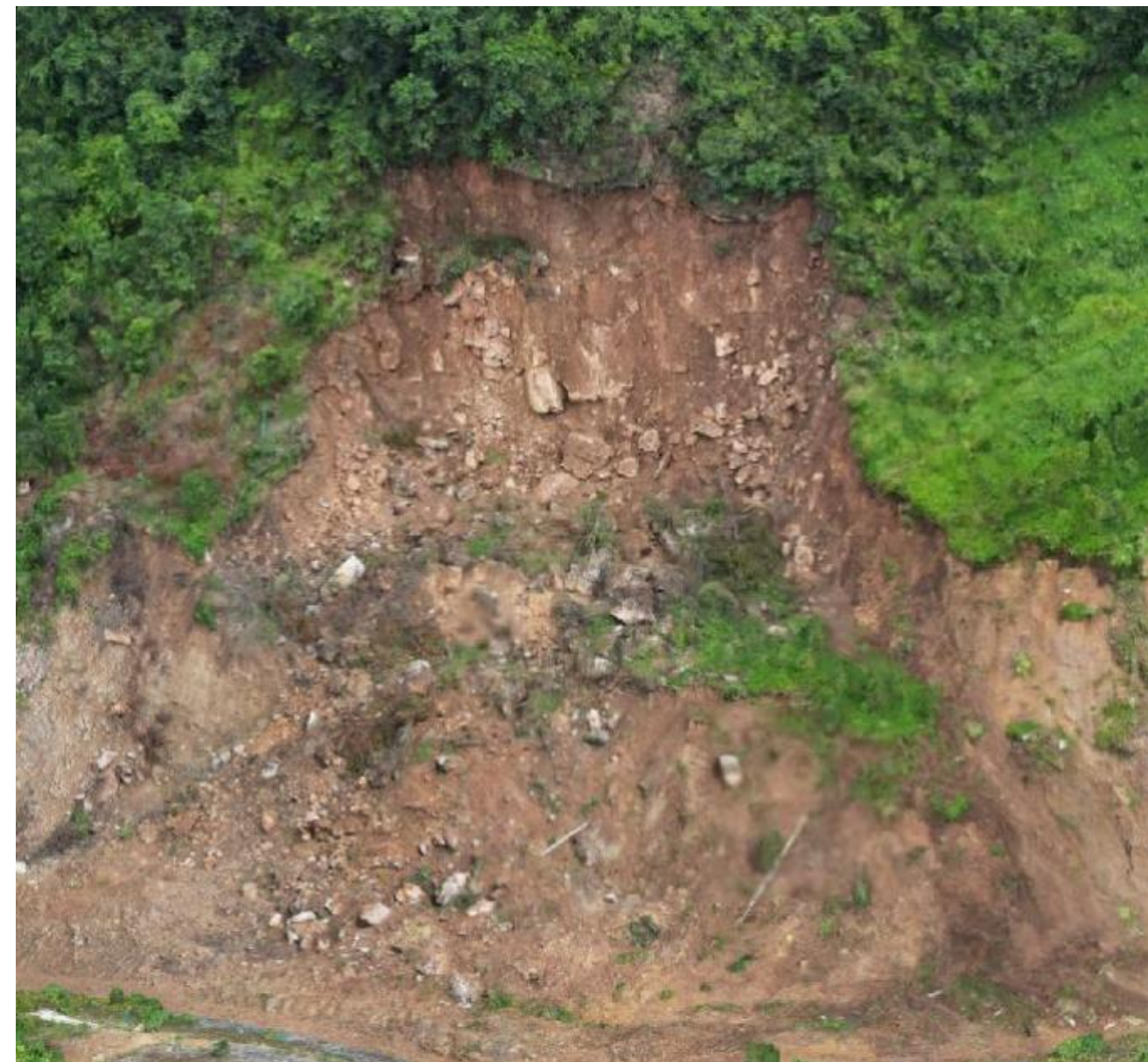
边坡滑塌航拍图
