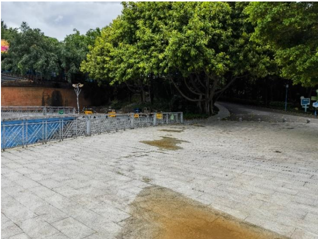
图 2-4 中部挡墙顶部沉降变形及积水
