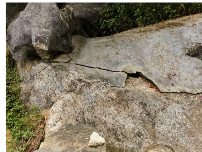
图 2-7 假山排水道表面开裂
