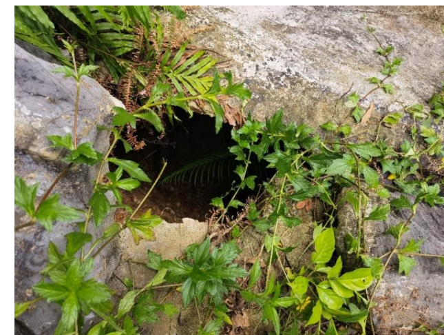
图 2-8 假山排水道底部掏空
