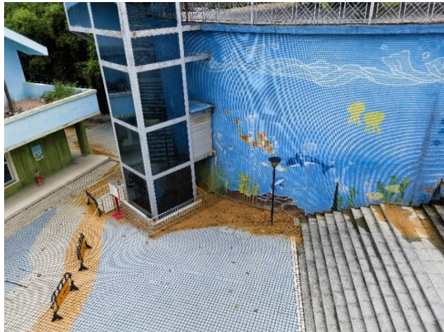
图 2-2 墙脚步梯渗水及填土流失
