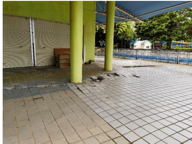
图 2-1 左侧挡墙顶部沉降变形及积水
