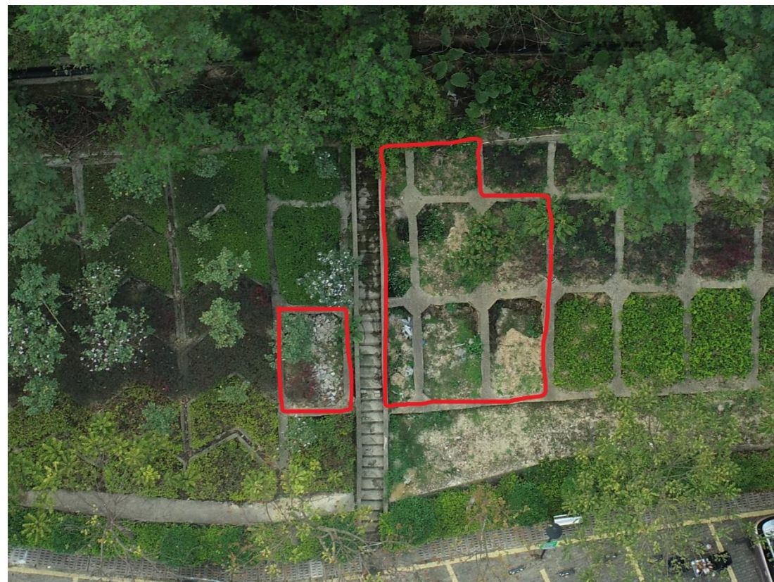
图 2-6 南门停车场边坡部分格梁间土体滑塌（局部照片）
