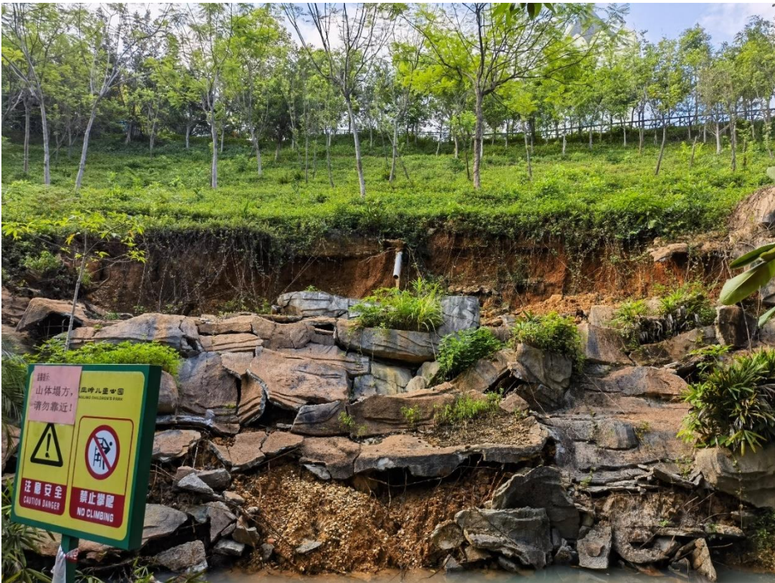
图 2-5 叠水瀑布边坡滑塌变形
