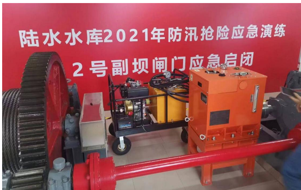
图 6-10-1 启闭机应急启动装置
