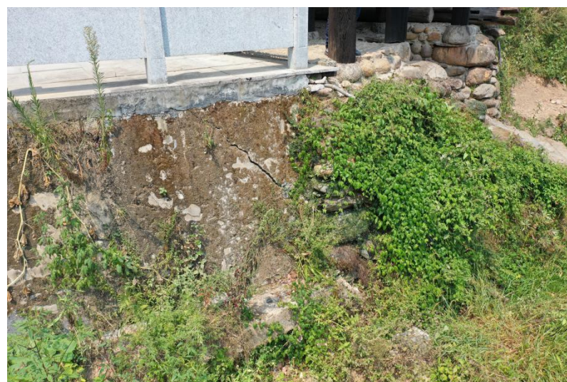
②挡土墙贯通开裂，长 3.12 米，宽 3cm
