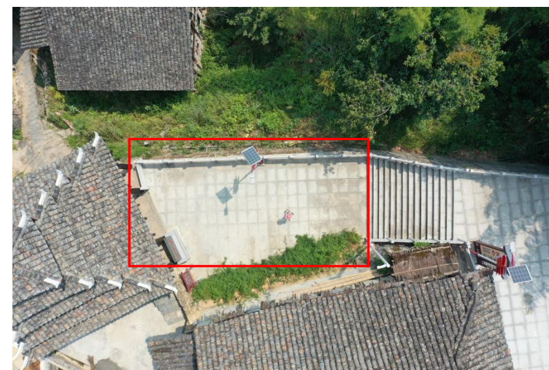
③地面下沉 1-2cm，青石板铺装开裂
