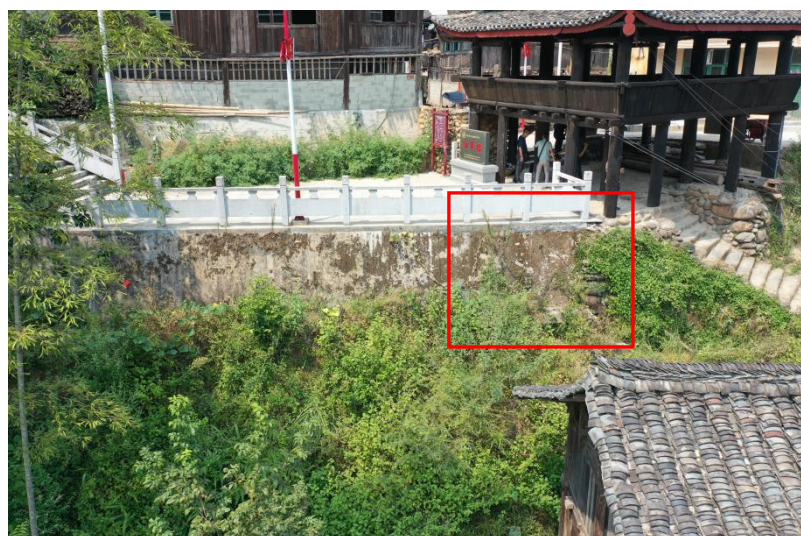
①挡土墙北端紧靠红军楼处开裂
