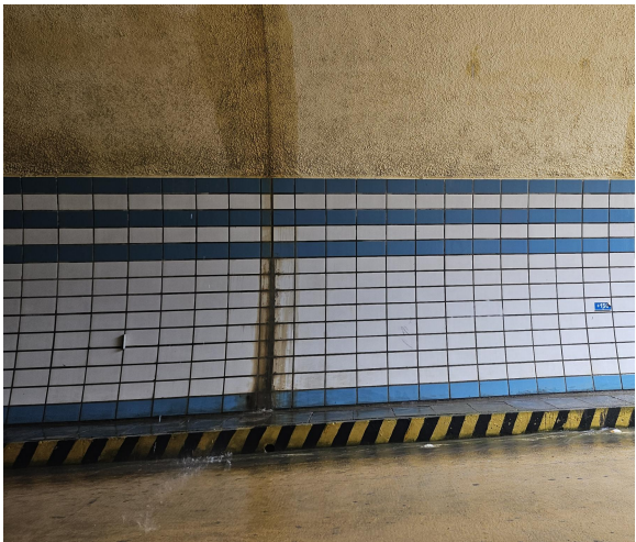
雨季隧道施工缝存在喷射水流
