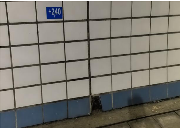
K1907+240 左边墙瓷砖破损
