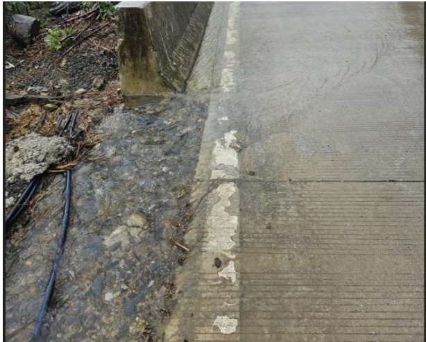
隧道出口端附近无路基边沟，雨水路面漫流
