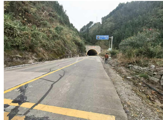
隧道出口标志牌及路面破碎板
