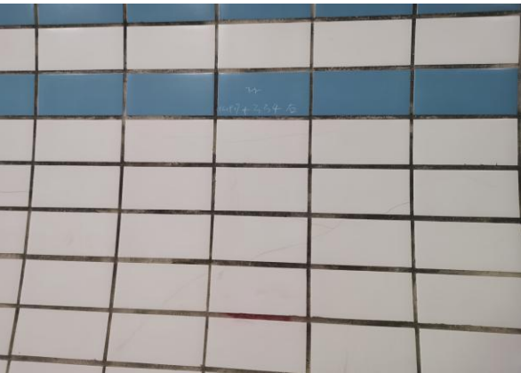
K1907+334 右边墙瓷砖环向裂缝
