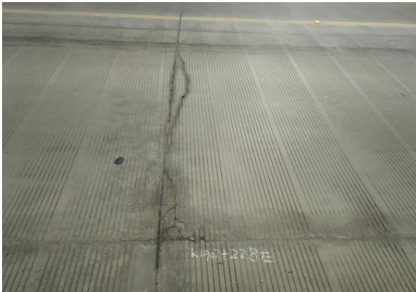
K1907+228 左路面横向裂缝
