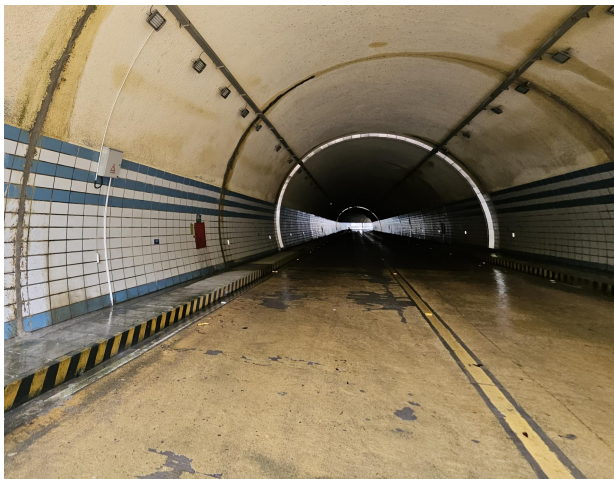
雨季隧道施工缝存在渗流，隧道路面湿润
