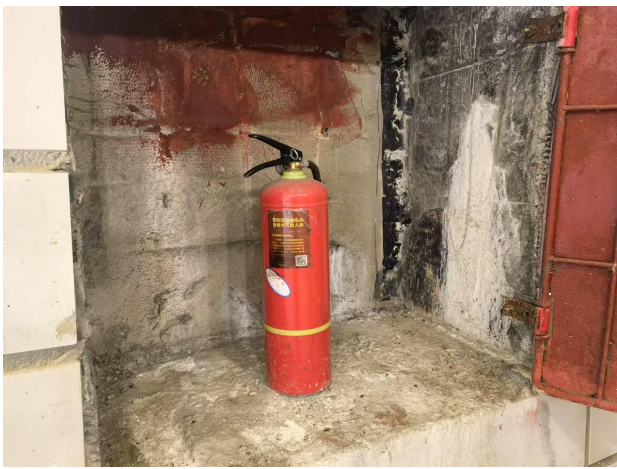
消防柜现状、灭火器不足，未做防水处理
