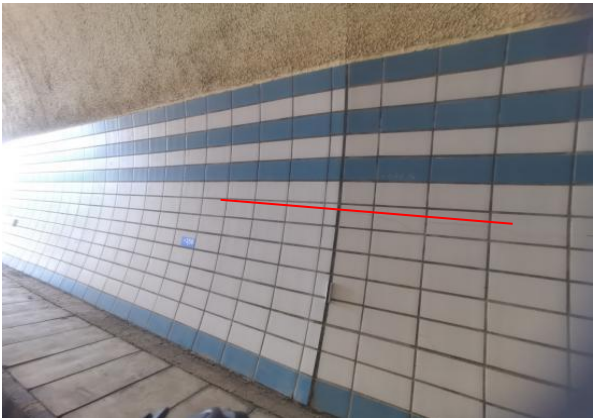
K1907+340~+348 右边墙纵向裂缝
