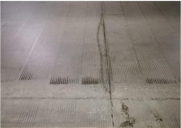
K1907+236 右路面横向裂缝
