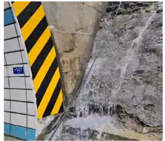
隧道入口端墙存在喷射水流，锥坡雨水冲刷
