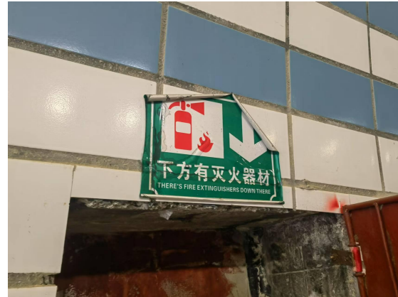
提示标牌破损
