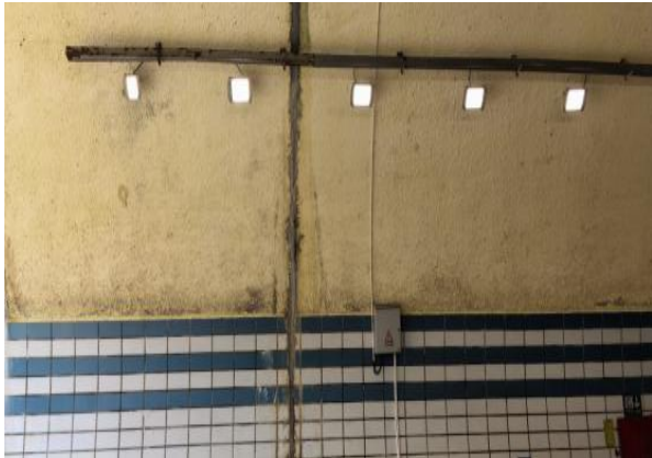
K1907+155 左边墙渗水
