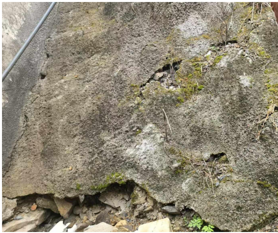
入口端墙锥坡坡面破损
