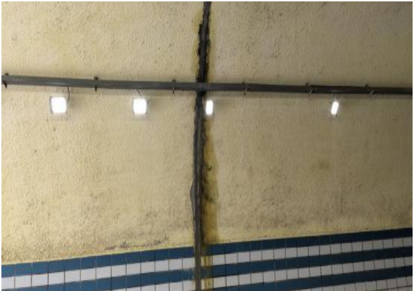
K1907+162 左边墙渗水
