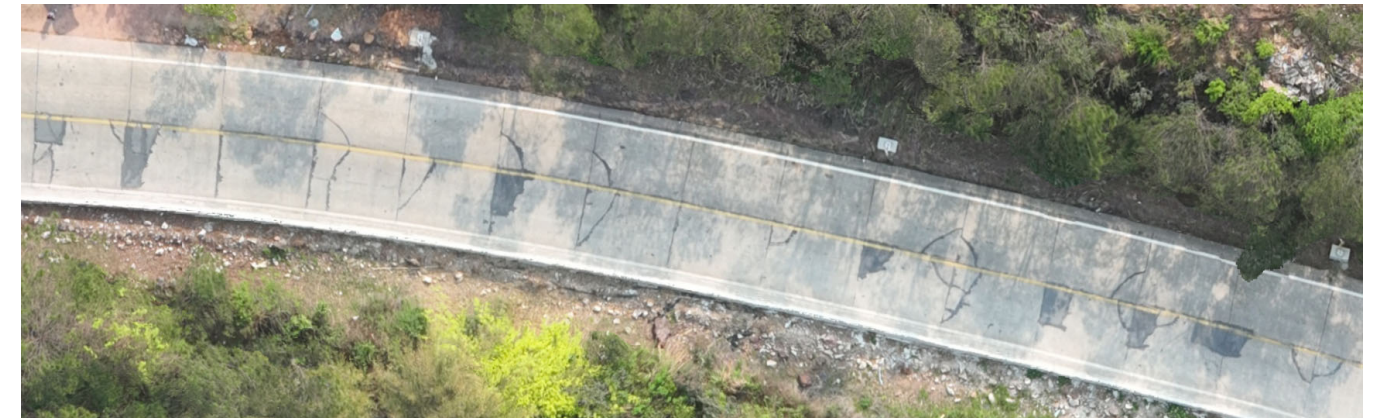
路面现状病害
