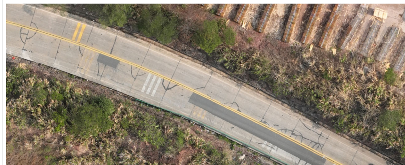
路面现状病害
